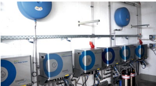
Mehrstufige Wasseraufbereitung der Draabe Hochdruck-Luftbefeuchtung.
