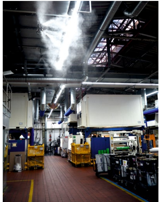
Doppelter Nutzen: Verdunstungskühlung der Luftbefeuchtung.
