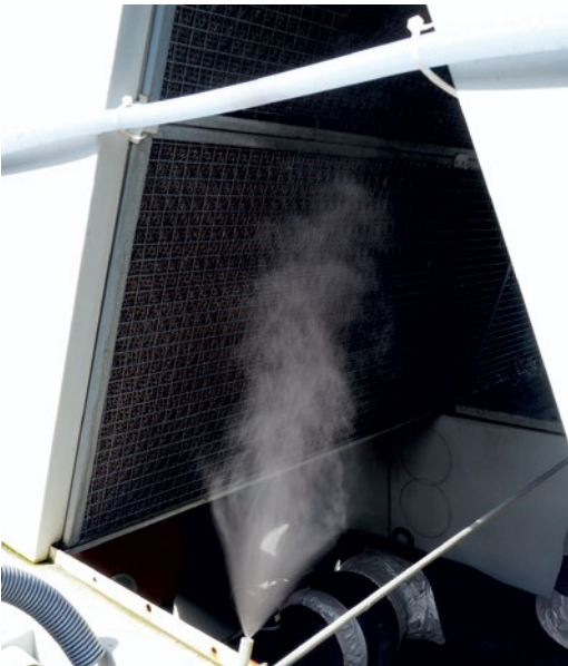
Verdunstungskühlung durch Hochdruckdüsen im Bereich der Kälteanlagen.
