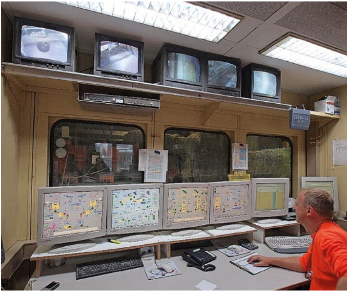
Moderne Steuerung der Deinking-Anlage.
