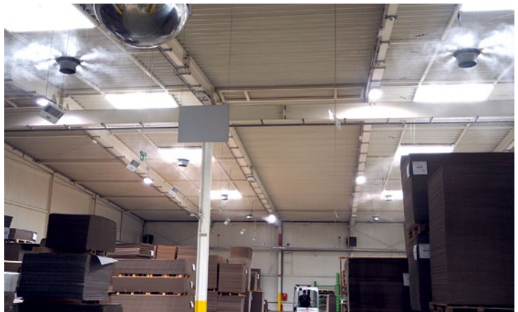
Eine kontrollierte Luftbefeuchtung gehört zur Qualitätssicherung bei Bart.
