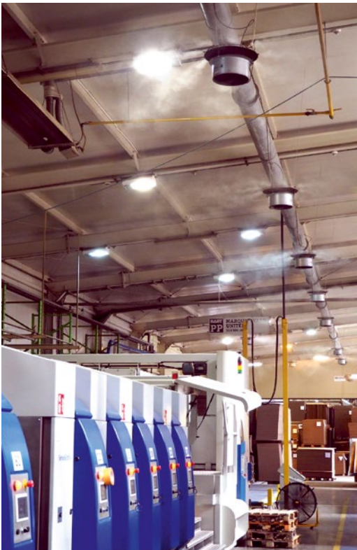
Die Condair ML-Luftbefeuchtung kühlt zusätzlich und reduziert Staub.
