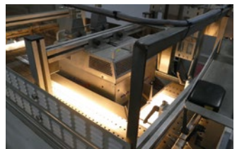
Die vorhandenen IR-Trockner können weiterhin genutzt werden.
