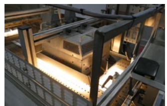
Die vorhandenen IR-Trockner können weiterhin genutzt werden.
