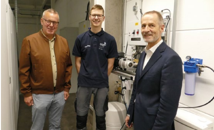
V. l.: Finestfog-Geschäftsführer Christian Wagner, der Offset- und Digitaldrucker Yannik Schobert und Aumüller-Geschäftsführer Stefan Aumüller vor der kompakten Lösung von Finestfog für die Luftbefeuchtung und das Reinwasser.
