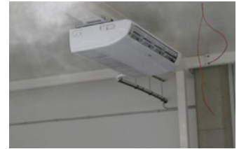
Eine zusätzliche Klimaanlage schützt vor Temperaturen über 26 °C.
