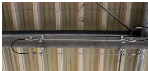
Die Düsen verrichten unauffällig ihre Arbeit und versprühen 20 Liter Wasser pro Stunde.
