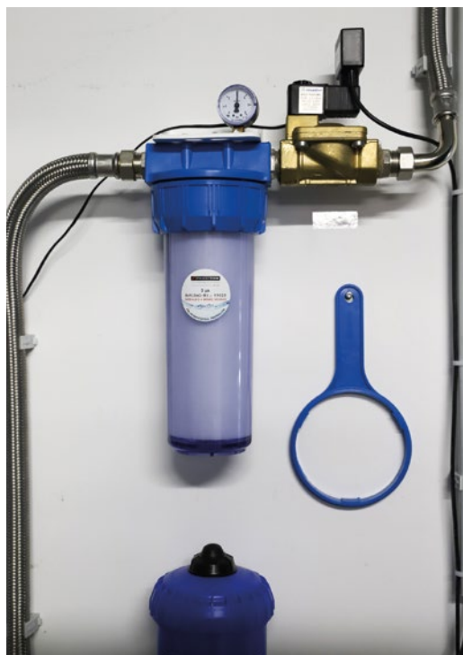
Der Feinfilter bereitet das Wasser vor dem Versprühen auf und schützt das System vor Verunreinigungen.
