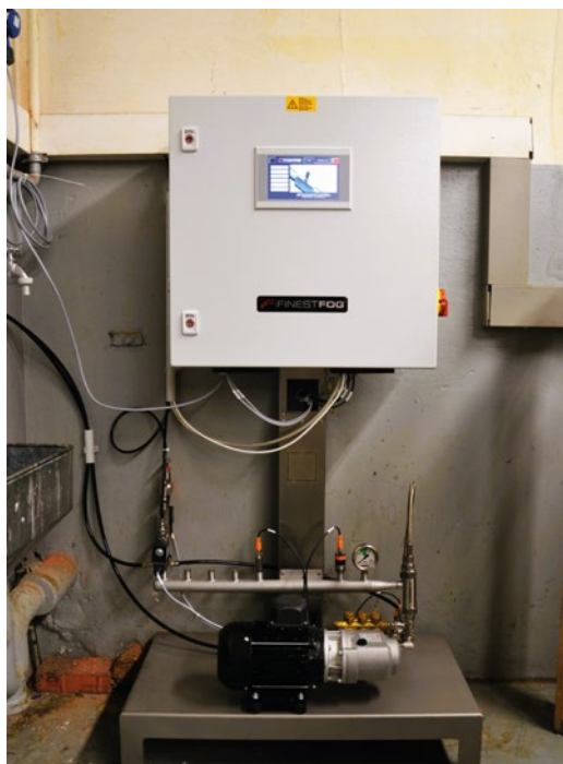
Kompakt und leistungsstark: Die Finestfog-Hochdruck-Luftbefeuchtungsanlage sorgt in Leer bei 21°C Temperatur für eine konstante Luftfeuchtigkeit von 50%.
